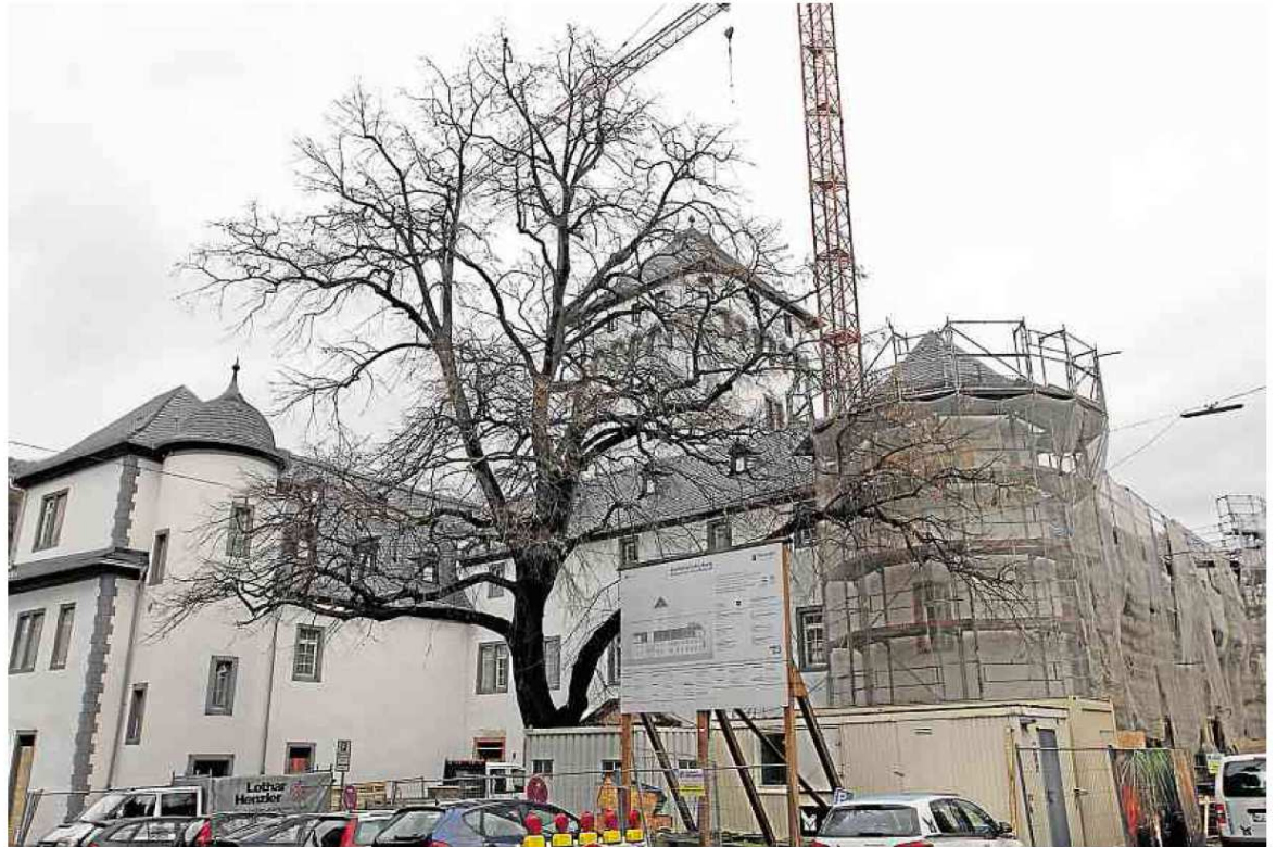
Seit nunmehr drei Jahren laufen die Sanierungsarbeiten an der Kurfürstlichen Burg in Boppard. Als Ende September Richtfest gefeiert wurde, waren bereits 5 Millionen Euro verbaut. Jetzt steht fest, dass die kalkulierten 8,7 Millionen Euro bei Weitem nicht reichen.
